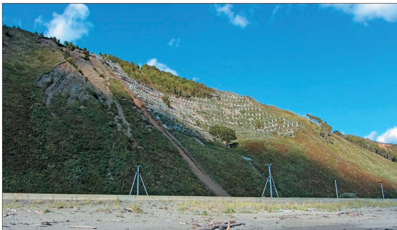
Выборочная застройка склона снегоудерживающими сооружениями на лавиноопасном участке железной и автомобильной дороги Южно-Сахалинск—Оха протяженностью около 1.5 км.
